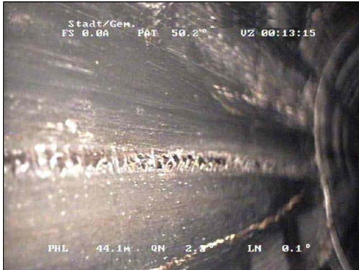
Aufklaffender Riss in einer PE-Leitung
