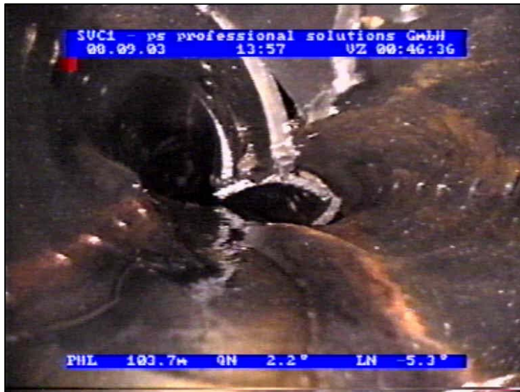
Einsturz einer gelochten PE-Sickerwasserrohr
