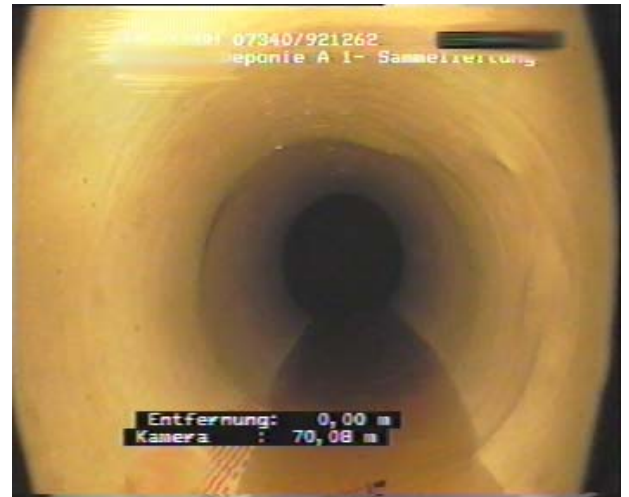
Sanierter Einsturz bei ca. 70 m
